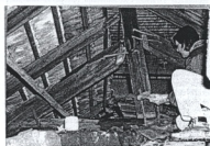
začiatkom uvoľnených spojov krovnej konštrukcie pivoňými kramlami
